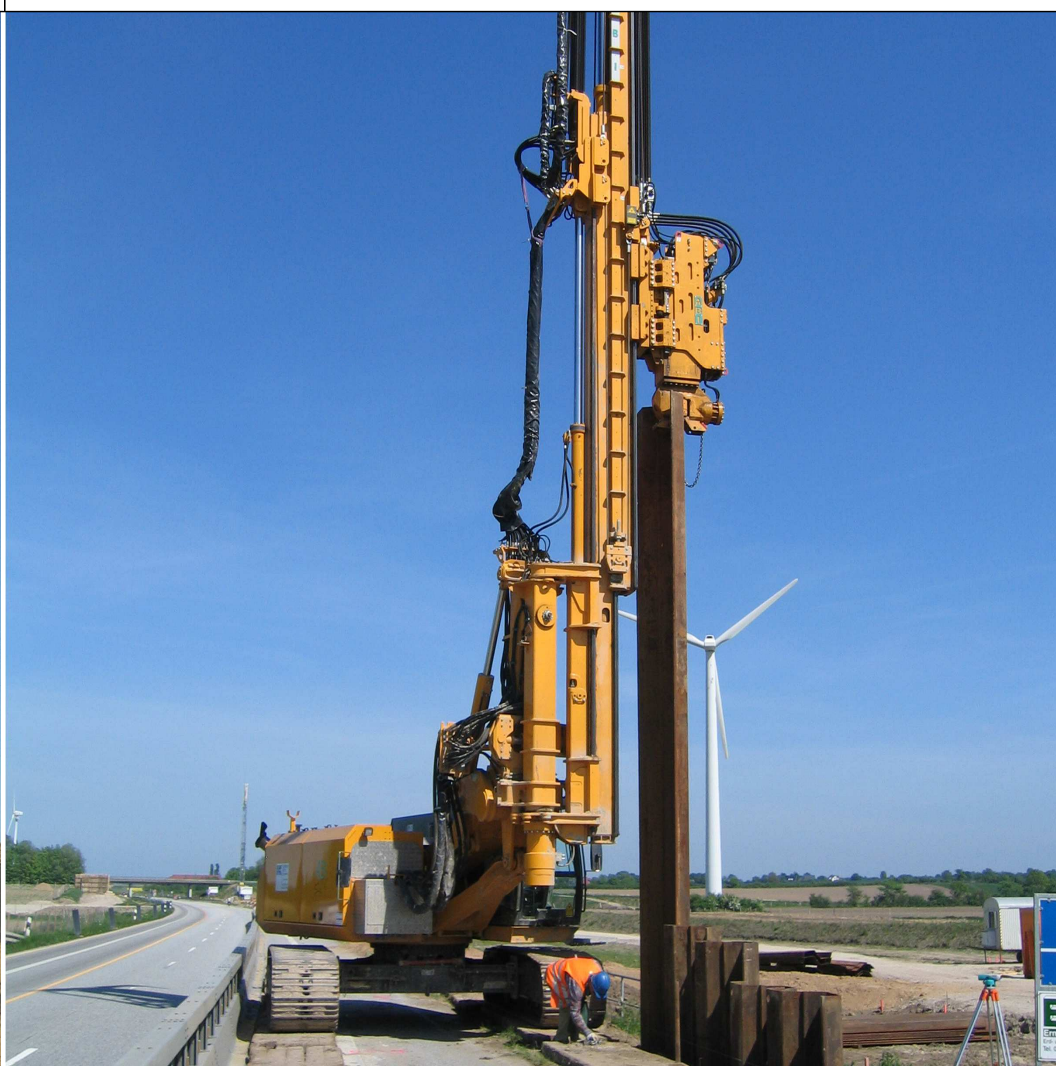
Vibrationsramme ABI TM 14/17 V SR 35T mit Vibrationsbär MRZV 18V Hermann Koth Ingenieurbau GmbH & Co.KG
